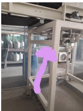
ภาพที่ 4 แสดงจุดตัดคานเหล็กขัดขวางการเคลื่อนไหวของพนักงาน
